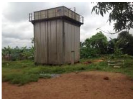
Photo 24 : Réservoir de Nkolnda II
