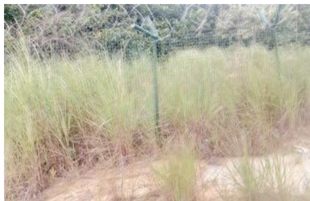
Photo 2 : Végétation herbeuse envahissant la route d'enceinte côté Bois des Singes
