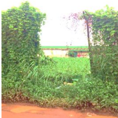
Photo 5: Clôture endommagée par un camion
